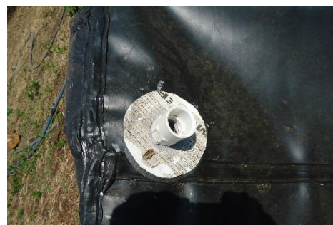
Sello de agua ingeniado para que biodigestor funcionara correctamente
