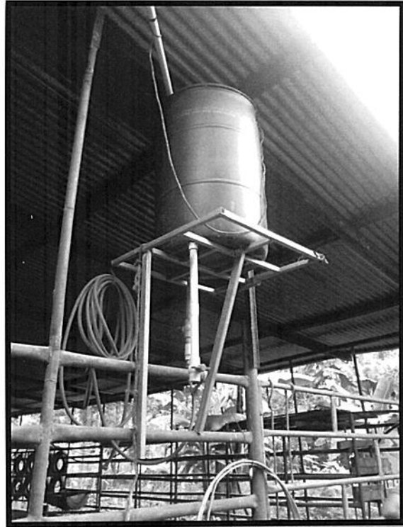
Antiguo sistema utilizado para lavado del corral con el agua tratada
