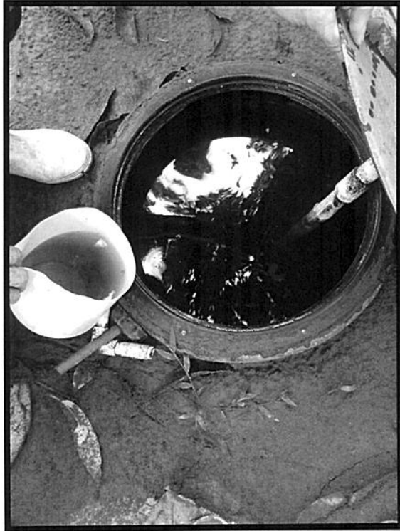
Tanque en el que se deposita el agua tratada
