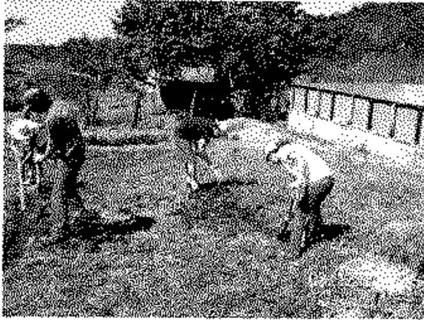
Estudiantes de la UNA preparando el terreno para la construcción del planché para la fabricación del abono orgánico.
